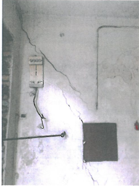
Spękanie ściany działowej w garażu nr 2
