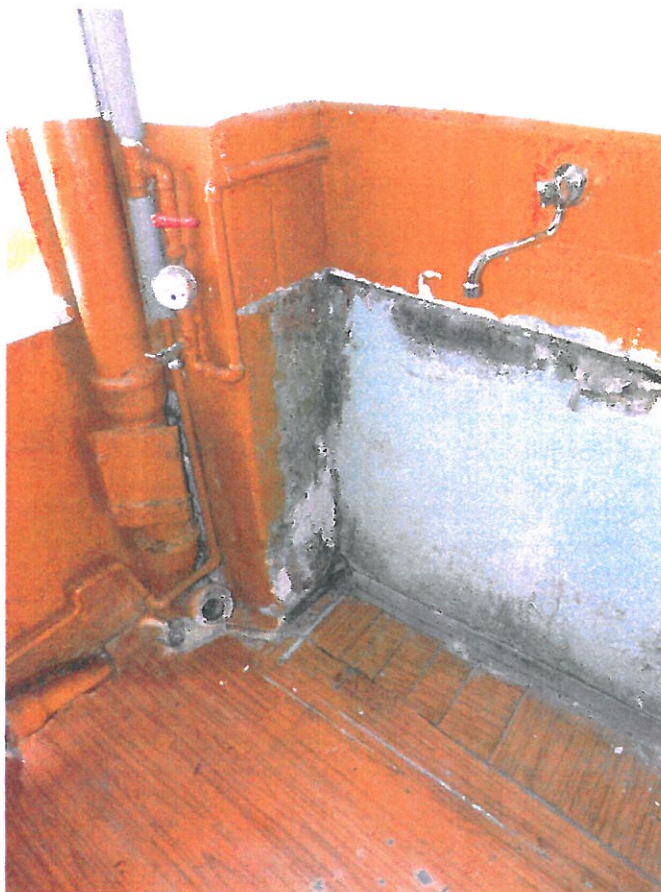
Instalacja wod-kan w pomieszczeniu nr 1
