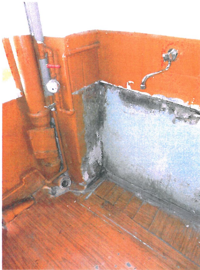
Instalacja wod-kan w pomieszczeniu nr 1
