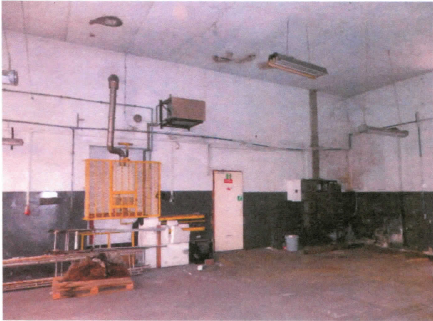
Piec gazowy z dmuchawą i układ elektryczny
