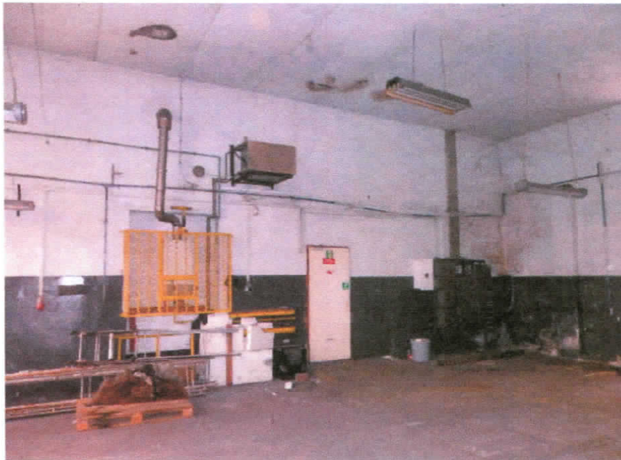
Piec gazowy z dmuchawą i układ elektryczny
