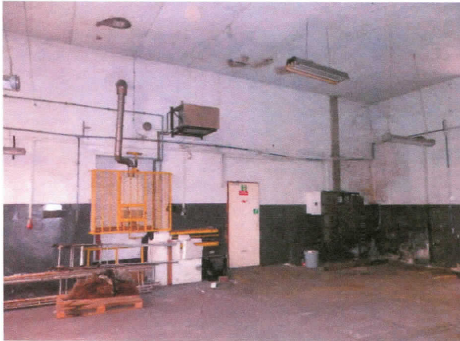
Piec gazowy z dmuchawą i układ elektryczny
